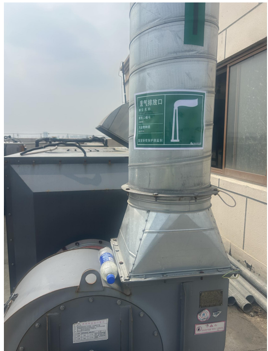
DA001 排气筒标识牌
