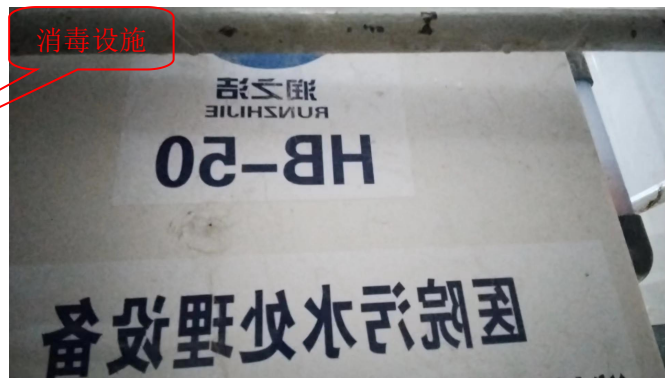
医疗废水消毒处理设施（水槽下方）
