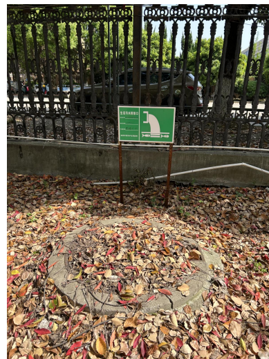
生活污水接管口
