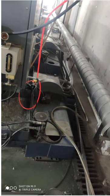
车间内乳化液废气收集
