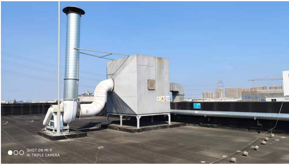
活性炭吸附装置+FQ1 排气筒
