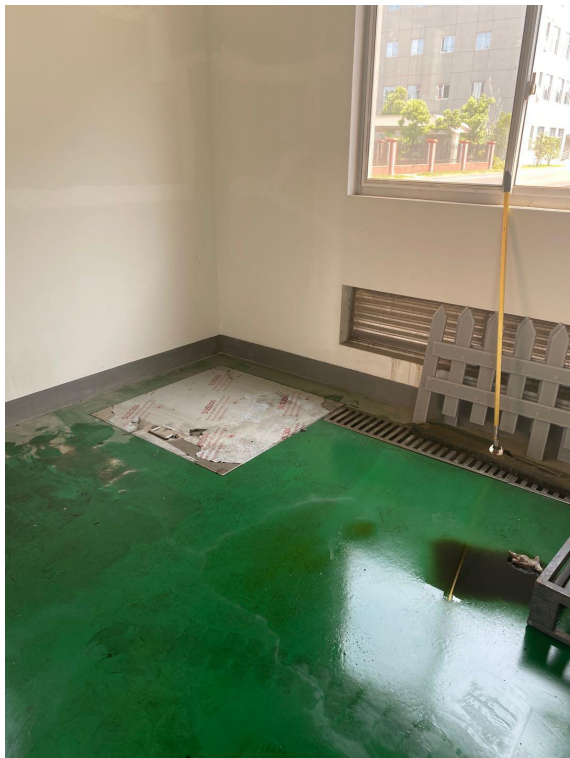
危废仓库导流沟集流井
