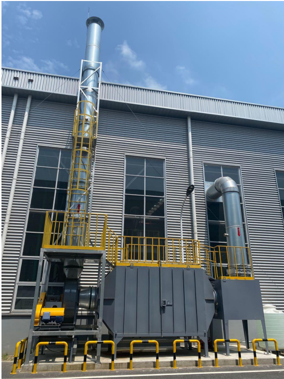
1#厂房 (FQ1) 废气排气筒
