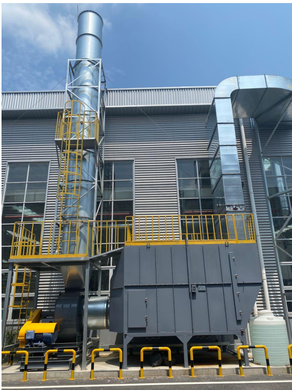
2#厂房 (FQ2) 废气排气筒
