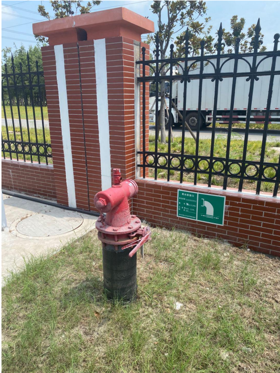
雨水排口及环保标识牌 (2)
