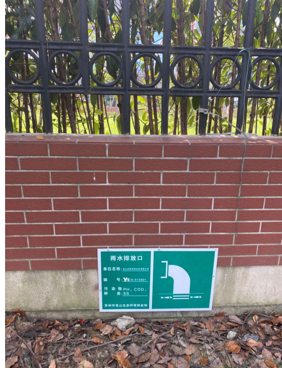
雨水排口及环保标识牌 (1)
